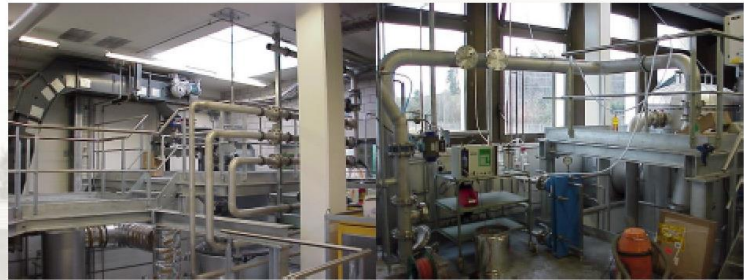
1996 - 2007: Pilot Plant, 120 kWel
